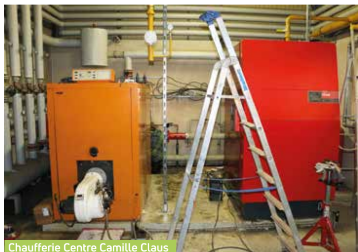
Chaufferie Centre Camille Claus
